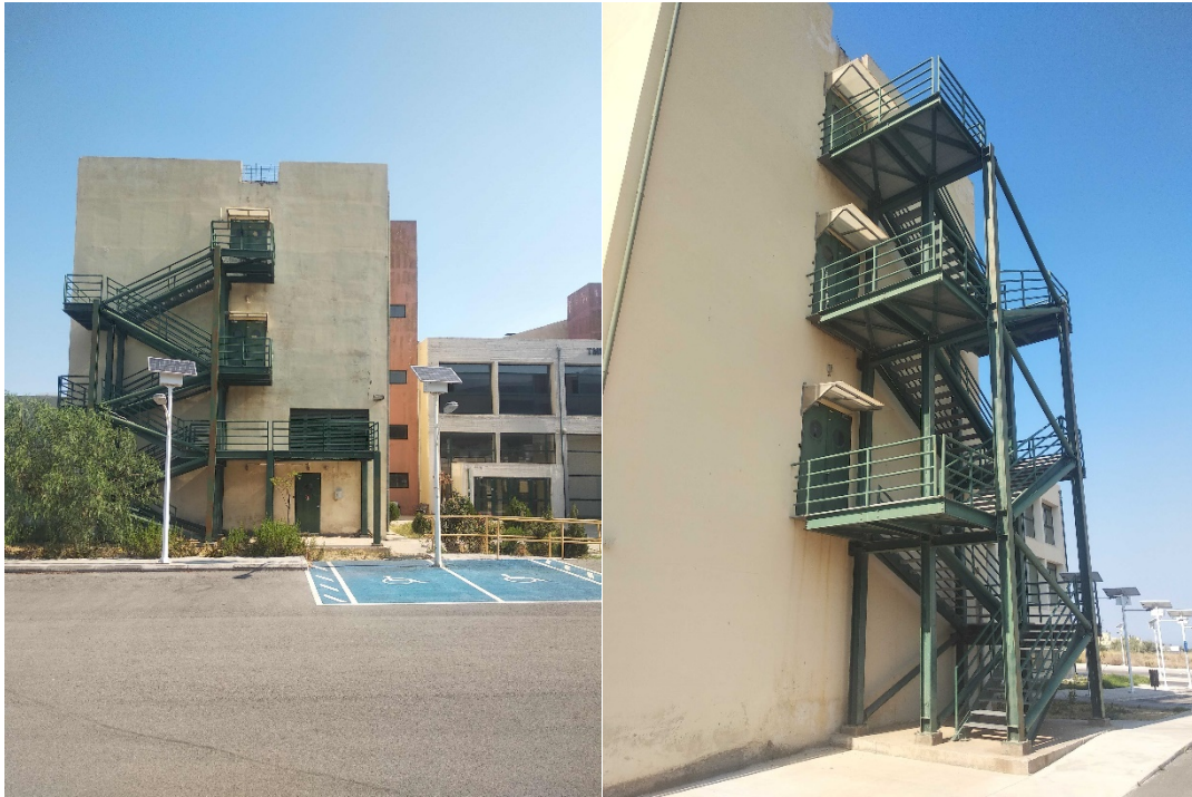
Φωτογραφία 1: Θύρες στα μεταλλικά κλιμακοστάσια προς αντικατάσταση.
