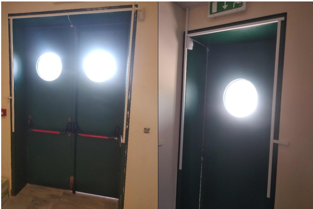
Φωτογραφία 2: Υπάρχουσες μεταλλικές θύρες προς αντικατάσταση.
